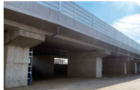
名神高速道路 一宮JCT～一宮IC間（上り線）橋梁補強工事
