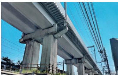
東京保線所管内土木構造物大規模改修その他工事 (RC橋R3) (東京都港区)
