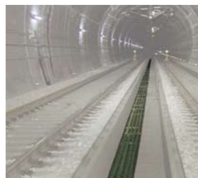
鉄道トンネル内配管状況
